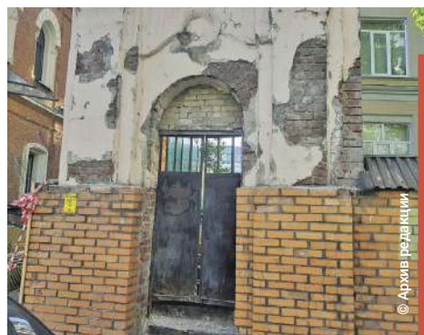
Арочный фрагмент ограды храма Спаса Преображения в 2022 году до ремонта
